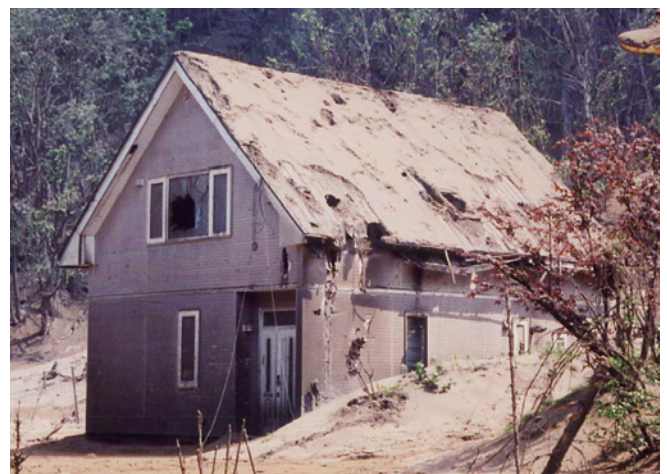
図3 火山灰が積もった後、噴石で打ち抜かれた住宅 (2000年有珠山噴火)
